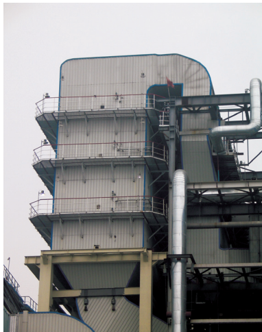
燃煤电厂脱硝设施
