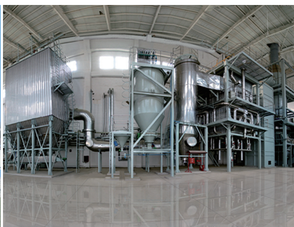
危险废物集中处置中心危险废物焚烧系统
